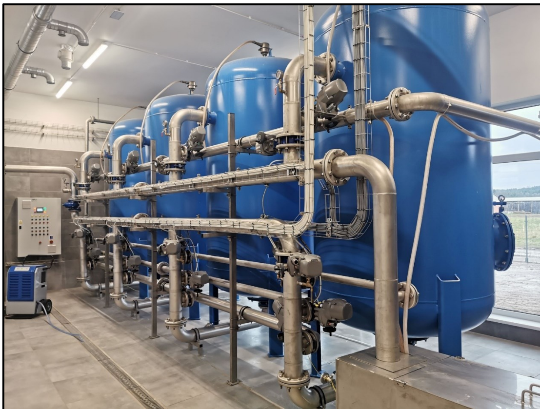
Stacja uzdatniania wody we Frankowie
